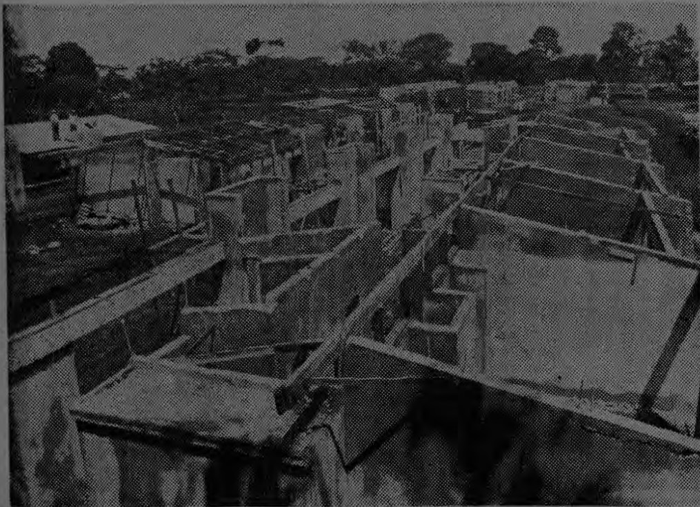
Vista panorámica de las obras en construcción del Hogar para Ancianos Alfredo y Delia González Flores, en Heredia. Las obras han avanzado en casi un 50% hasta la fecha.
